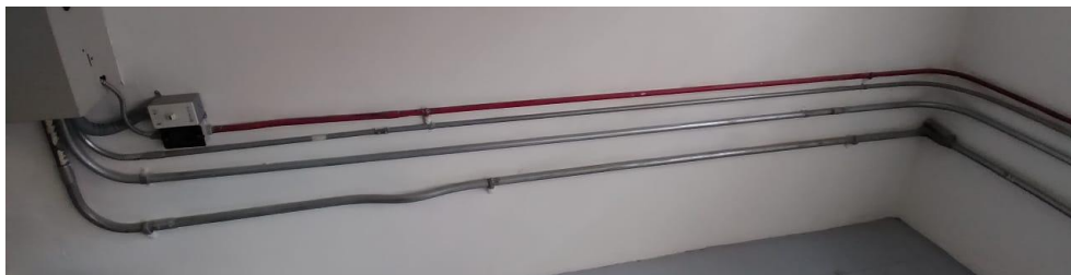
Ilustración 3. Tuberías de servicios eléctricos en muro de lado derecho.
