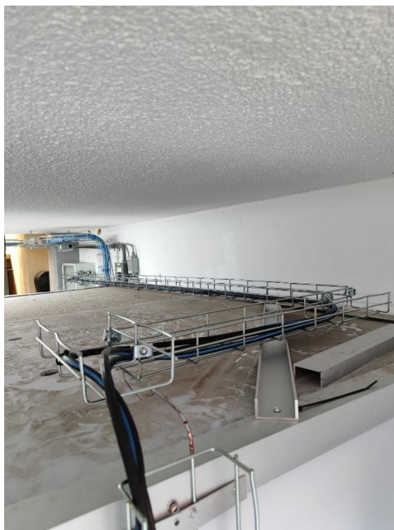
Ilustración 75. Acomodo de cables por medio de charolas.
