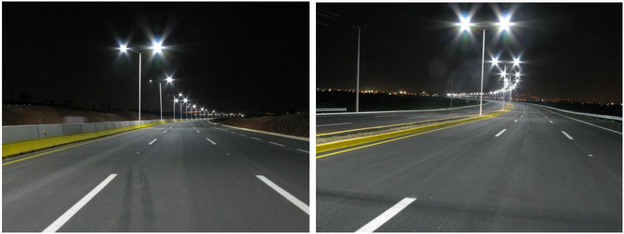
FIGURA IV.11: Luminaria LED instalada en el Periférico de la Ciudad de Guadalajara, Jalisco.
