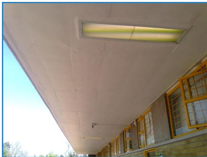
FIGURA VI.4: Luminaria encendida en pasillo de la Facultad de Ingeniería a plena luz del día.
