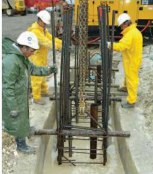
Figura V. VI Acero de refuerzo colocado en la zanja del muro Milán, guiado por el brocal
