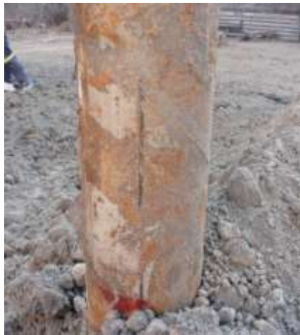
Figura V. III Ademe de un pozo de absorción, se observan las ranuras y la malla de protección
