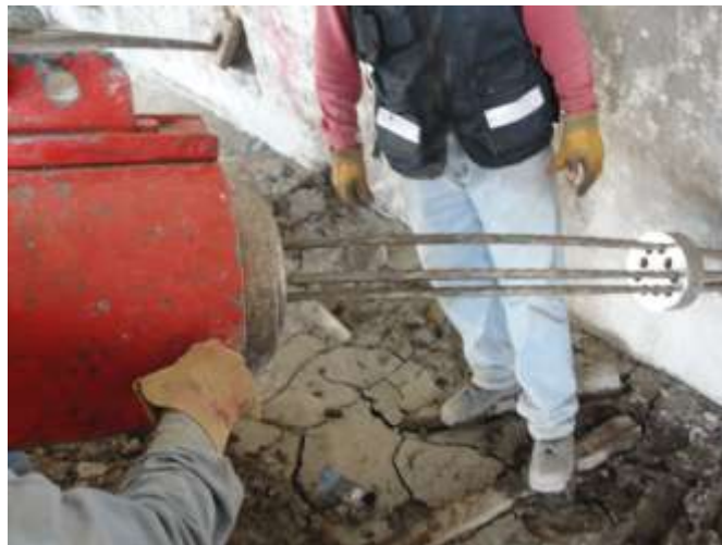
Figura IV. XI Colocación del gato hidráulico para el inicio del tensado, previamente se colocó el queso de bloqueo
