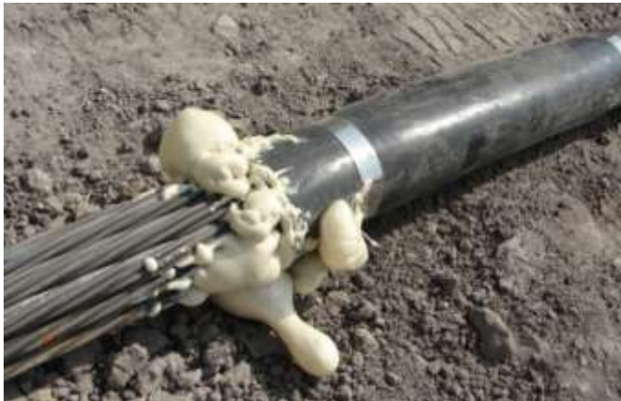
Figura IV. V Sello impermeable entre la Longitud Libre y la Longitud de Bulbo de un ancla
