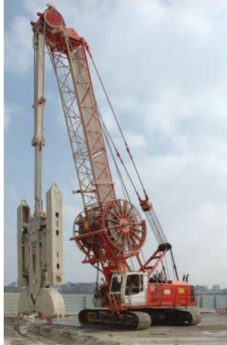
Figura V. VII Almeja hidráulica, de gran potencia y permite grandes avances en la excavación del muro
