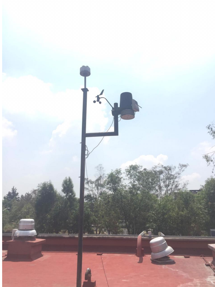
FIGURE 2.1: Boltek EFM-100 instalado en el Instituto de Geofísica, desde marzo de 2017 a junio de 2019
