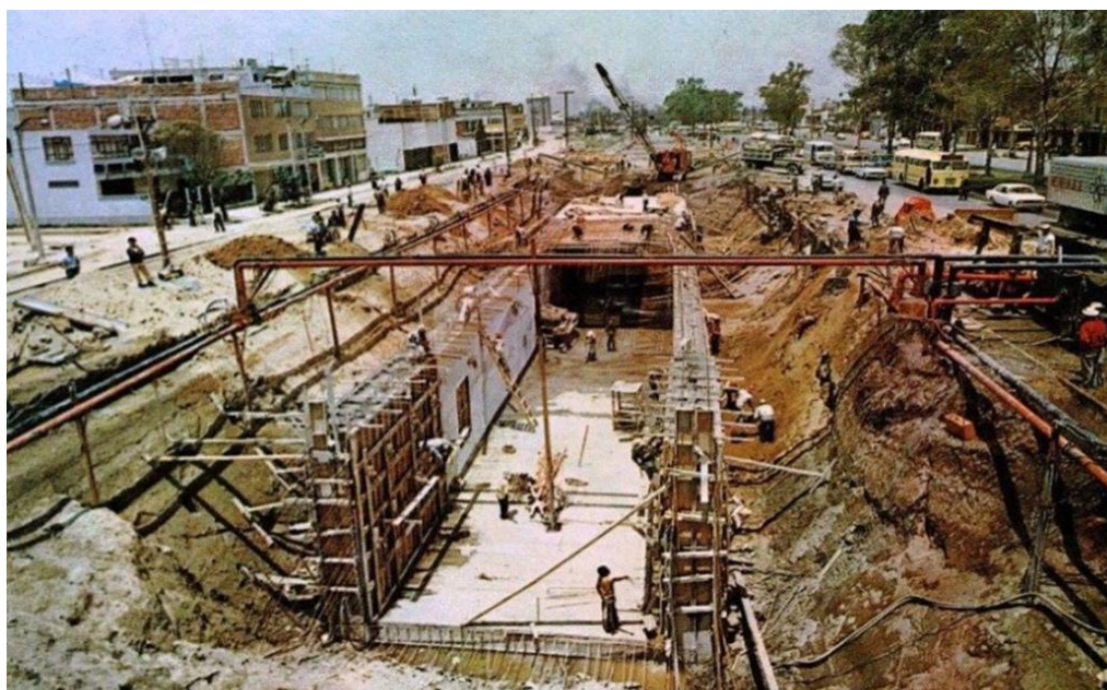
Figura 19. Inicio de los trabajos de construcción de la línea A del sistema Metro (DDF, 1968).
