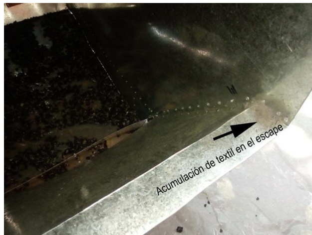
Figura 44: Acumulación del textil en el escape de la cámara de separación por gravedad.
