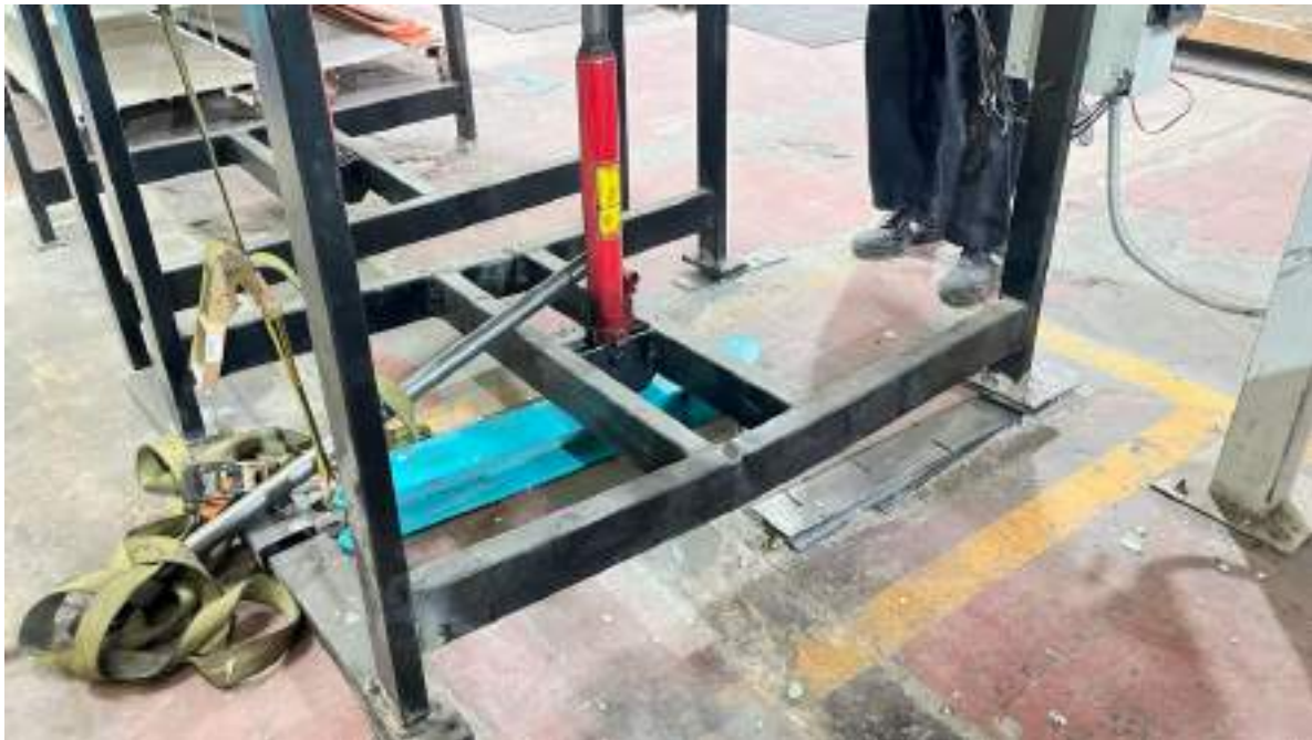
Fig. 22. Evidencia de deformación plástica permanente en geometría tipo "U" en el bastidor principal de la SheetPress.
