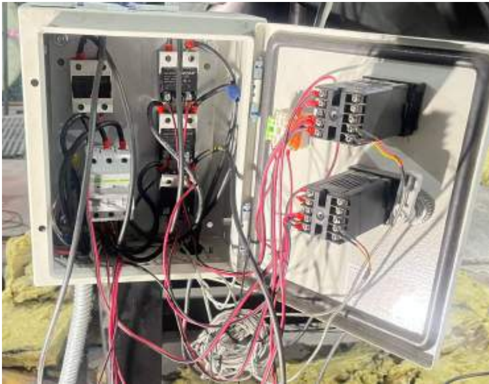
Fig. 13. Arquitectura interna del tablero de control y distribución de potencia de la SheetPress.
