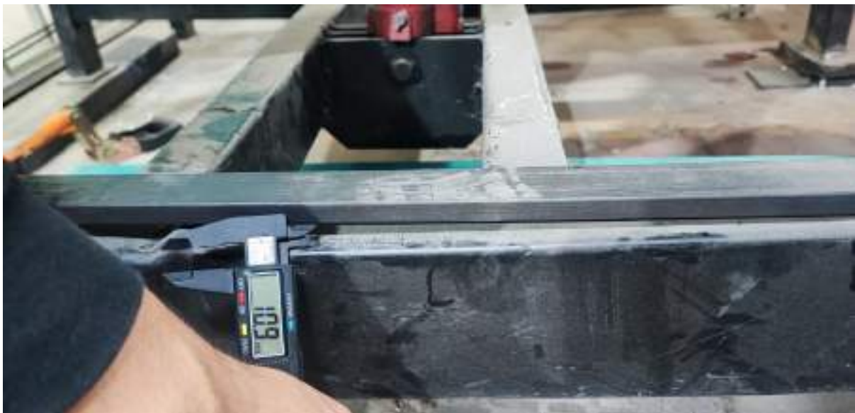
Fig. 25. Medición física del desplazamiento vertical en el travesaño del bastidor bajo carga estática.
