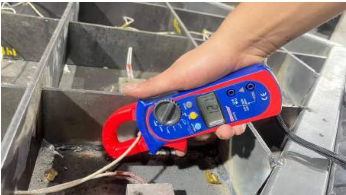
Fig. 14. Medición de corriente en tiempo real, evidencia de sobrecarga de 12.1 Amperes en conductores calibre 14 AWG.
