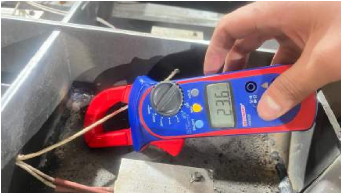
Fig. 15. Medición de corriente en tiempo real: evidencia de sobrecarga (23.6 A) en conductores calibre 14 AWG.
