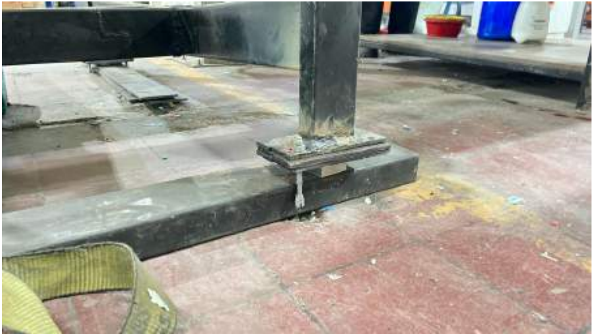
Fig. 23. Elevación lateral del bastidor provocado por el desprendimiento de anclajes debido a esfuerzos mecánicos inversos y momentos flectores parásitos.
