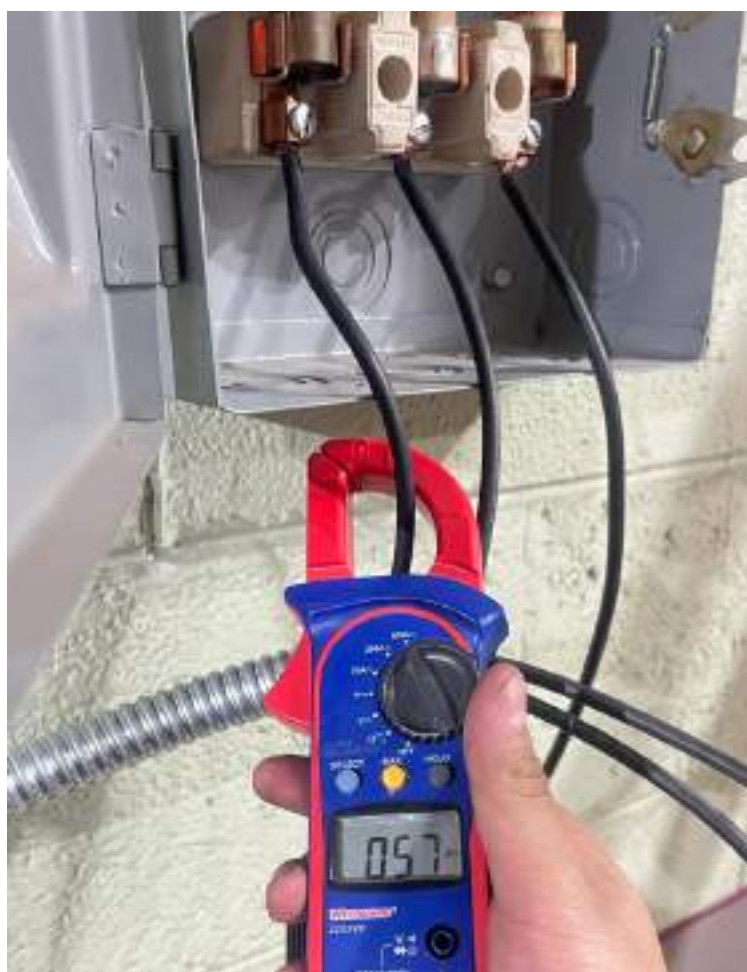
Fig. 16. Medición del amperaje de línea en la entrada principal a la Prensa Térmica.
