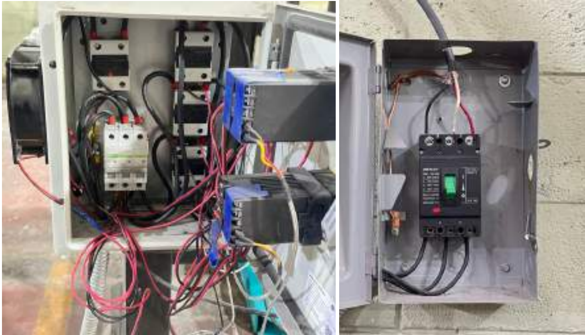
Fig. 19. Actualización del tablero de control y distribución de potencia.
