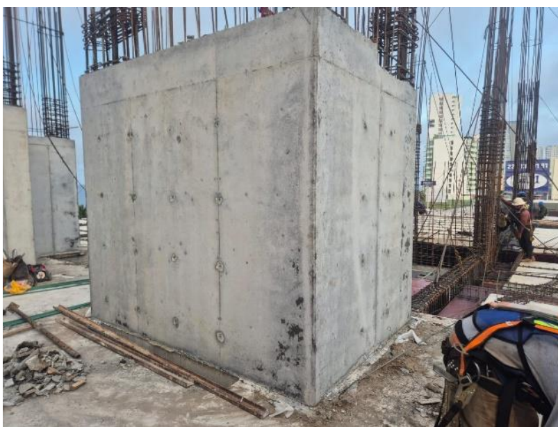
Imagen 19. Resultados de muro core en Torre Tauri.
