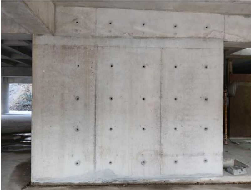
Imagen 20. Resultados de muro core en Torre Tauri.
