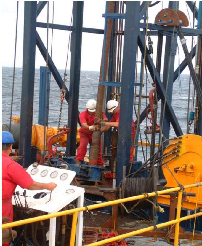
Figura III.2. Sistema de perforación.
