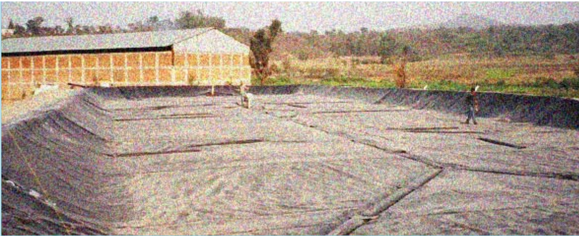
Figura 5.8 Cubierta de laguna con geomembrana de polietileno
