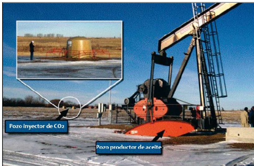
Figura 5.4 Instalaciones superficiales típicas de un campo con inyección de CO 2 ; instalaciones superficiales en Weyburn.
