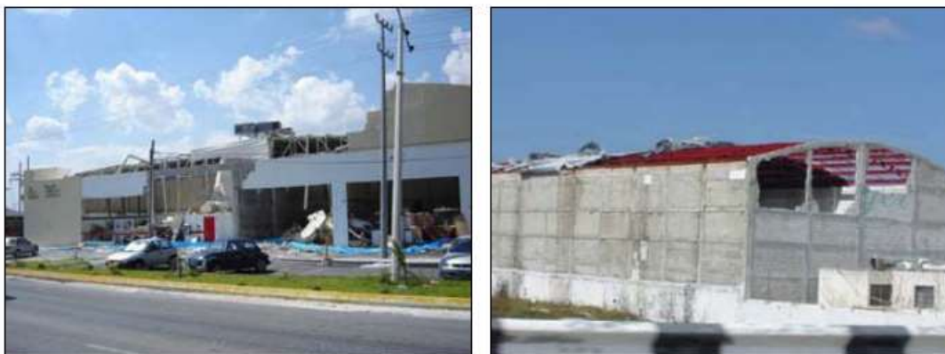
Figura 10 Daños en bordes de estructuras ligeras (Avelar Frausto, 2017)
