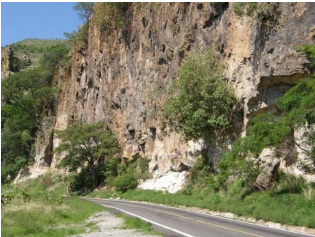
Fotografía V.3 Vista de norte a sur del talud. Obsérvese el fracturamiento vertical que se extiende a todo lo alto del talud
