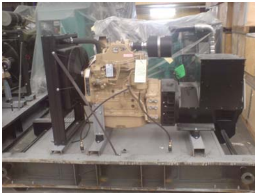
FIG 1. Planta Eléctrica en Proc.
