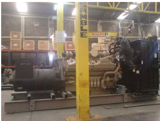
FIG 7. Equipo de 1600 kW en Área de Ensamble.
