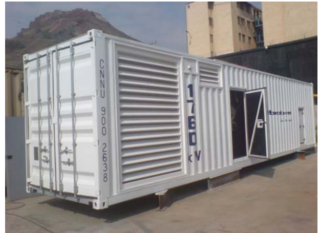
FIG 6. Equipo de 1760Kw en contenedor.
