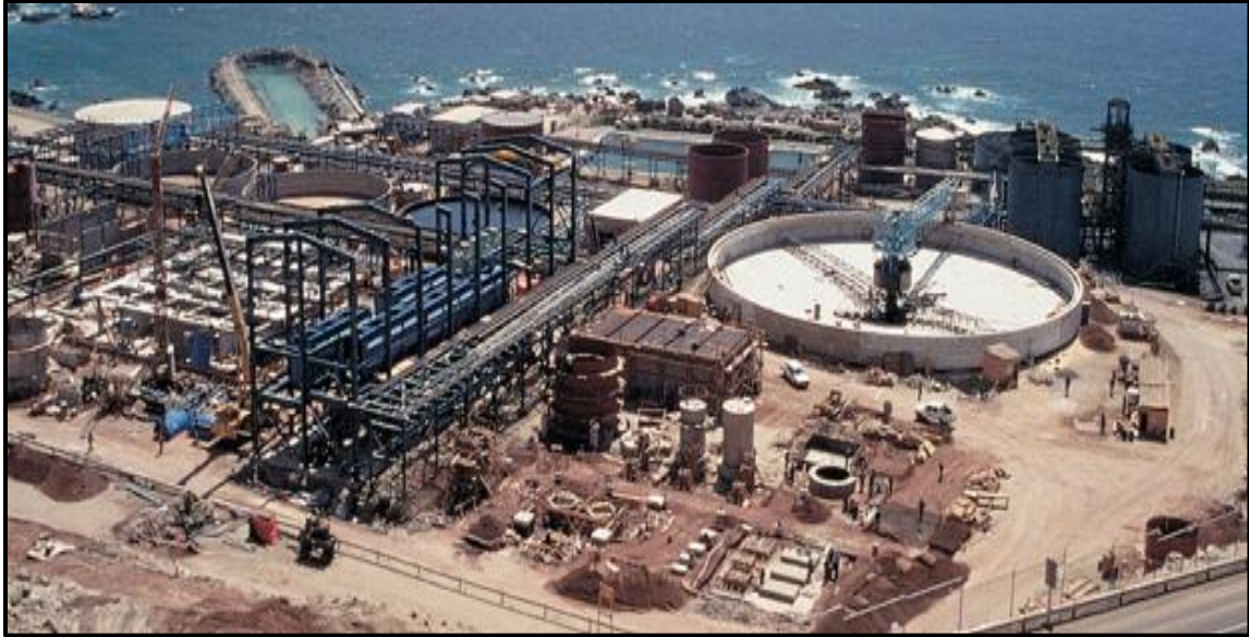
Figura 4. 29. Planta desalinizadora de agua de mar "La Escondida". Fuente: BHP Billiton Approves Escondida Water Supply Project (BHP, 2021).
