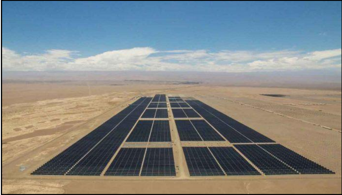
Figura 4. 50. Parque solar fotovoltaico que suministra energía a Collahuasi. Tomada de Collahuasi y Sonnedix firman contrato por 150 GWh de energía solar y el primero en Chile con respaldo de baterías (COLLAHUASI, 2020).
