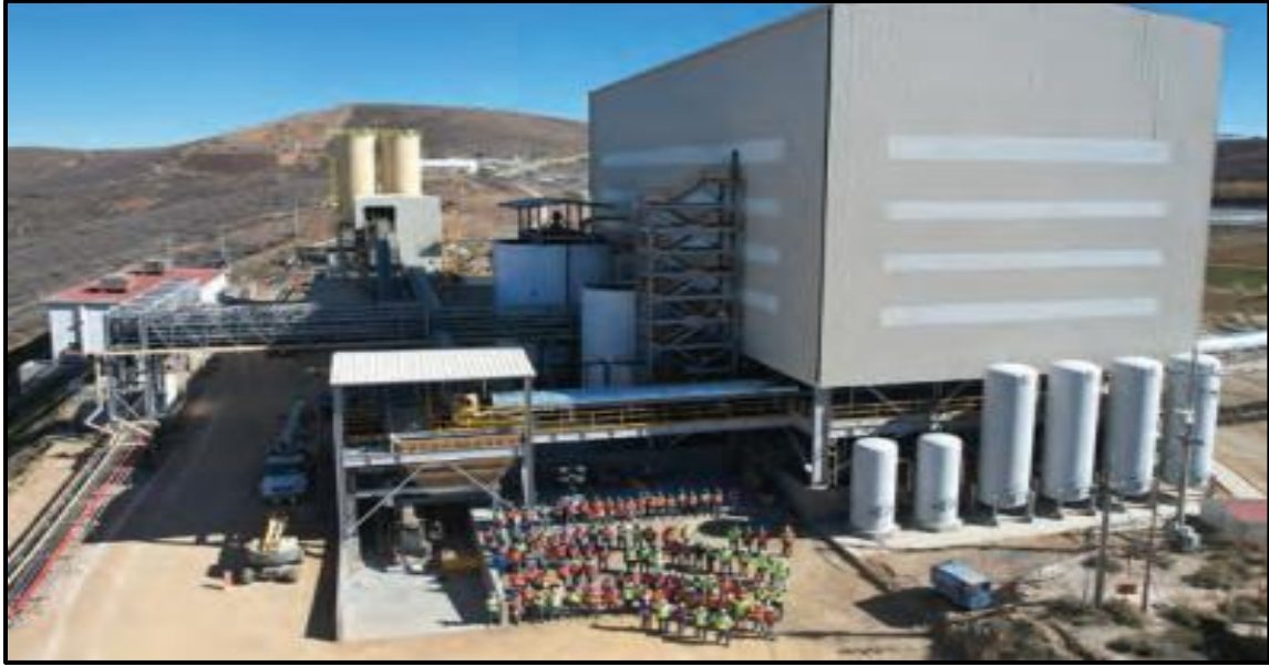
Figura 4. 3. Planta de tratamiento de jales para relleno de obras subterráneas. Tomada de Sustainability Report Capstone Gold 2023 (Capstone Gold, 2024).
