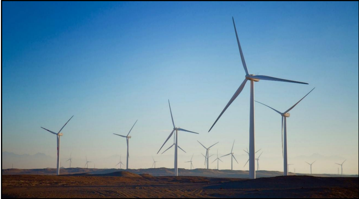
Figura 4. 49. Central Eólica Punta Lomitas que abastece de energía a la operación Quellaveco. Fuente: Central Eólica Punta Lomitas entra en operación comercial (ENGIE, 2023).
