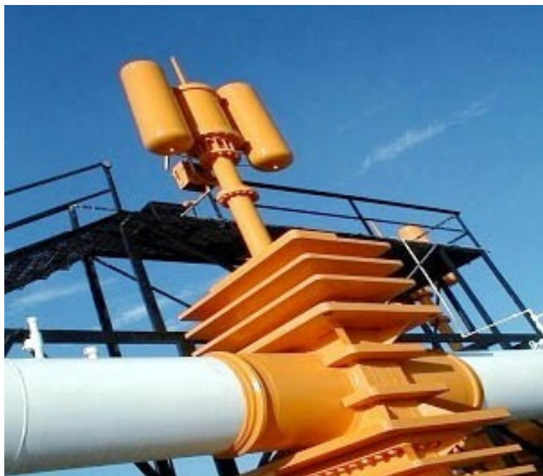
Fig. 8 Vista de una válvula de seccionamiento de 24"
