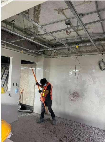
Imagen 102 Colganteo de soportería con alambre galvanizado. Elaborado por el autor.
