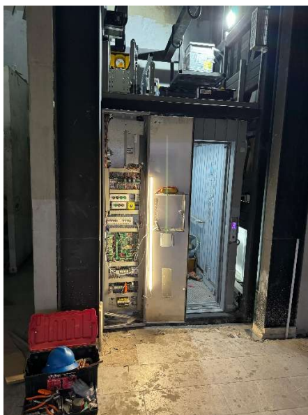
Imagen 80 Gabinete de control de elevador. Elaborado por el autor.
