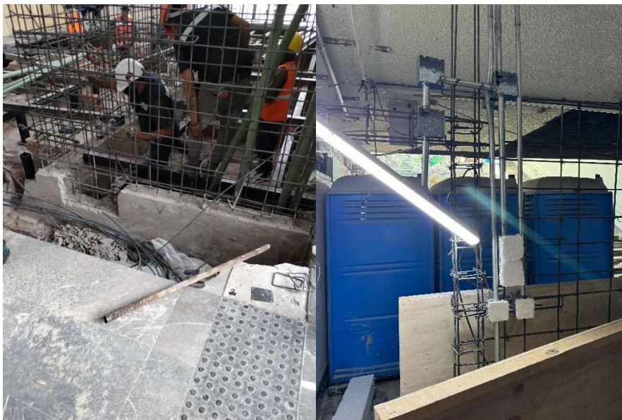
Imagen 93 Instalación de tubería conduit sobre acero de refuerzo. Elaborado por el autor.
