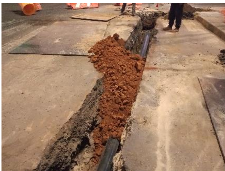
Figura 49. Acostillamiento en la colocación de tubería. Fuente: elaboración propia
