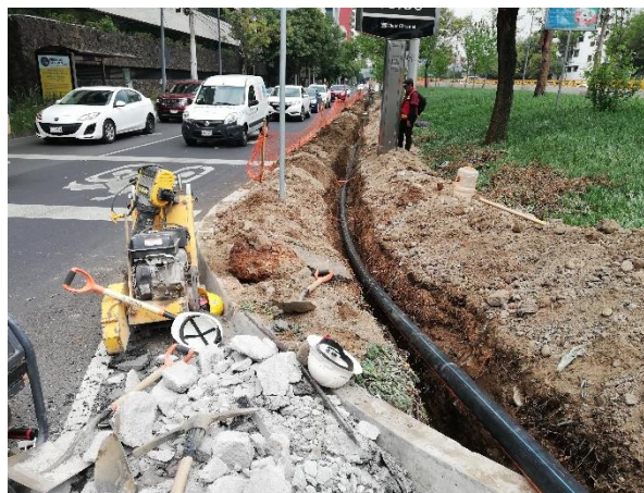
Figura 15. Línea de conducción de agua potable de 4". Fuente: elaboración propia
