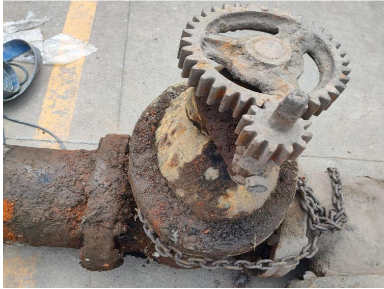
Figura 12. válvulas de compuerta existente con deterioro por paso de los años, Fuente: elaboración propia
