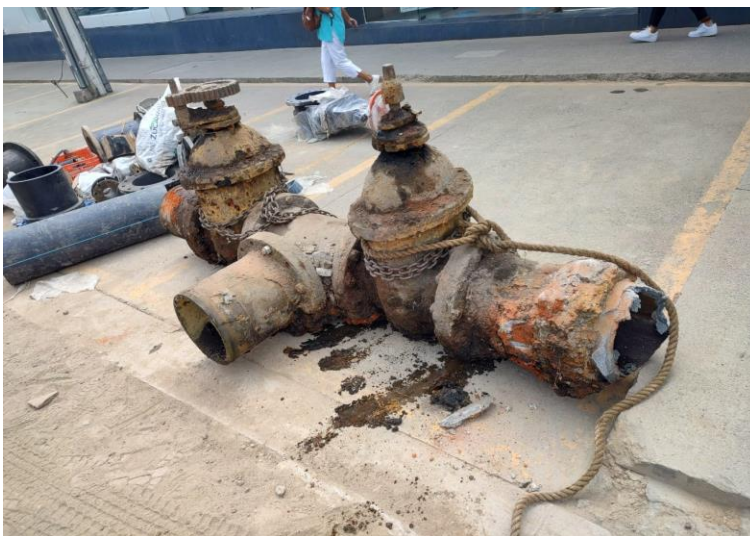
Figura 11. Tren de válvulas existentes con tubería de fibro-cemento, deteriorado por paso de los años, Fuente: elaboración propia
