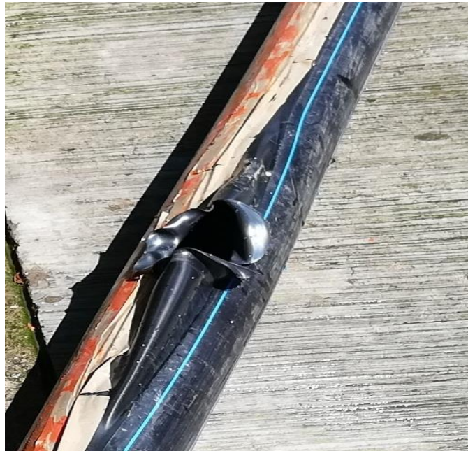
Figura 46. Falla de tubería en el proceso de prueba hidrostática, esta se realizó durante el día a una temperatura de 32°C) Fuente: elaboración propia
