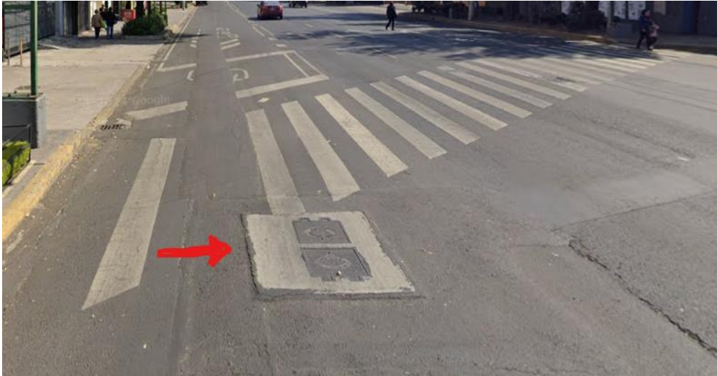
Figura 90. Caja de interconexión de agua tratada Eje 8 y Prolongación Uxmal. Fuente: elaboración propia
