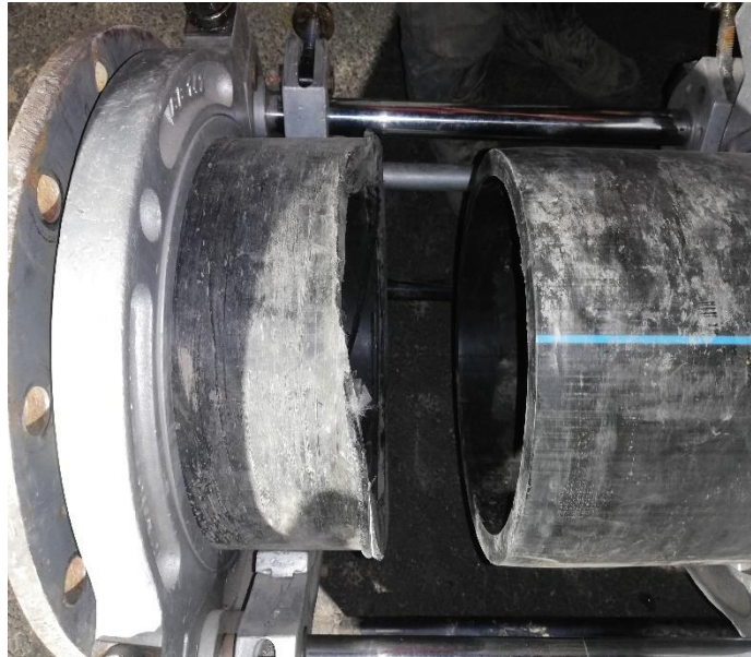
Figura 40. Ejemplo de extremo desalineado. Fuente: elaboración propia
