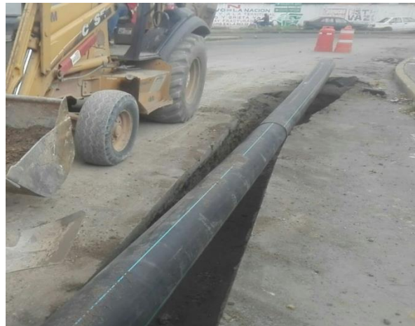
Figura 14. Línea de conducción de agua potable de 12". Fuente: elaboración propia
