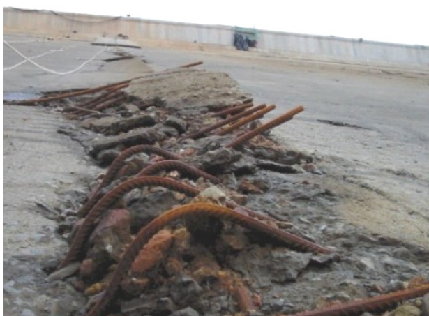
(a) Junta vertical entre las losas 16 - 17
