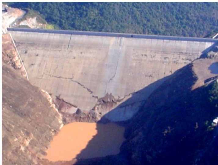
Figura 1.1 Agrietamiento en la cara de concreto de la presa Campos Novos, en Brasil, junio de 2006
