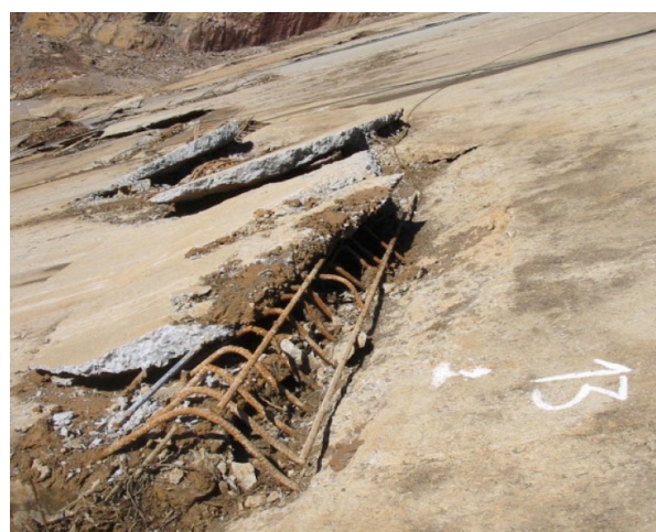
(b) Grieta horizontal
