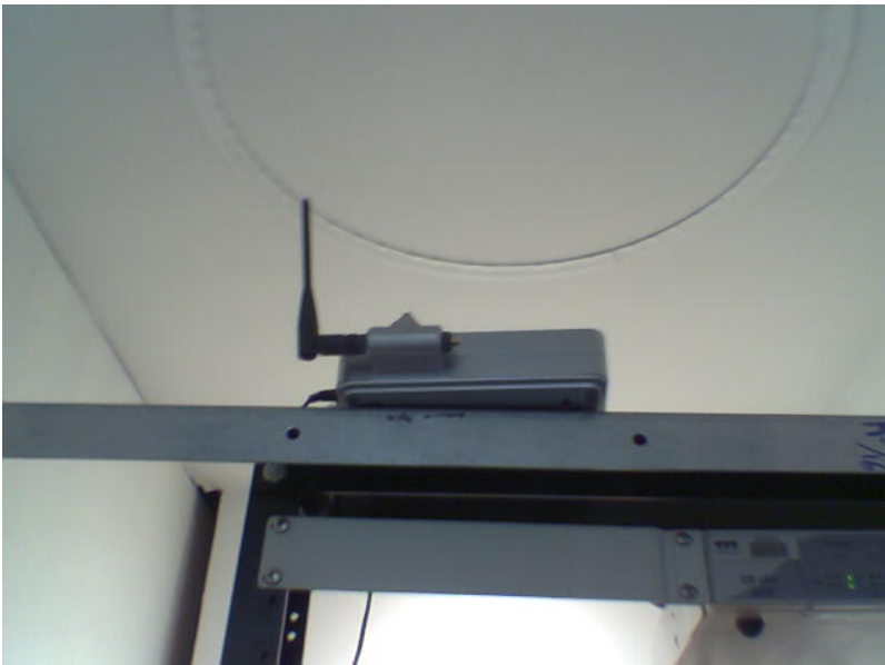
Figura 5.14. Instalación en Dirección General/Enseñanza/Biblioteca (Sala de juntas).
