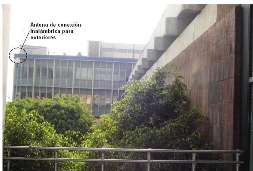
Figura 5.17. Antena exterior inalámbrica ya instalada.
