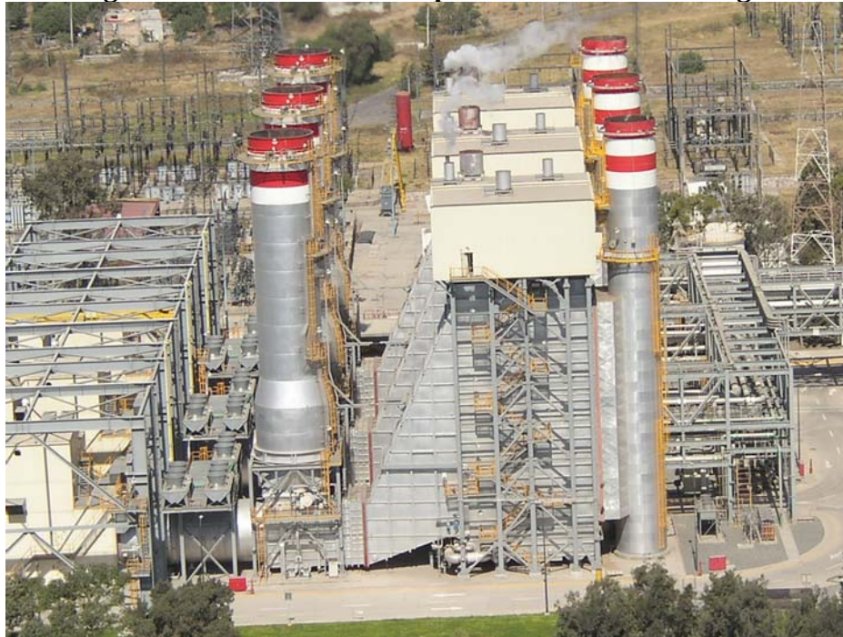
Figura 2.3 Chimenea de escape de las unidades turbogas
