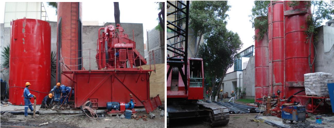
Planta de suministro y tratamiento de lodo bentonítico.
