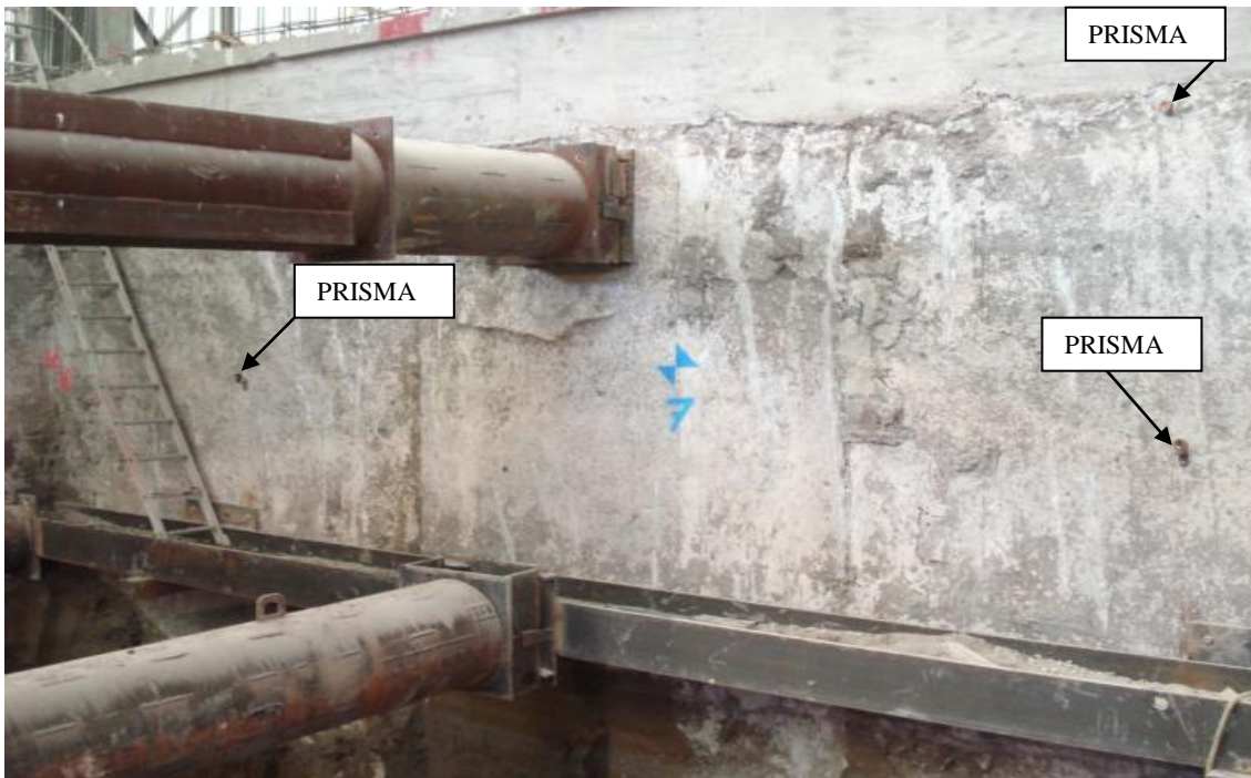
Prismas ubicados en el muro Milán, panel 7 y 8 zona Oeste.
