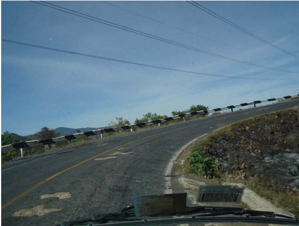
FIGURA 3.6 ESTADO ACTUAL DE LA CARRETERA A HOSTOTIPAQUILLO
