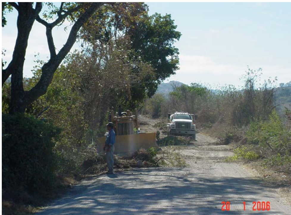
FIGURA 3.9 ESTADO ACTUAL DEL CAMINO DE ACCESO
