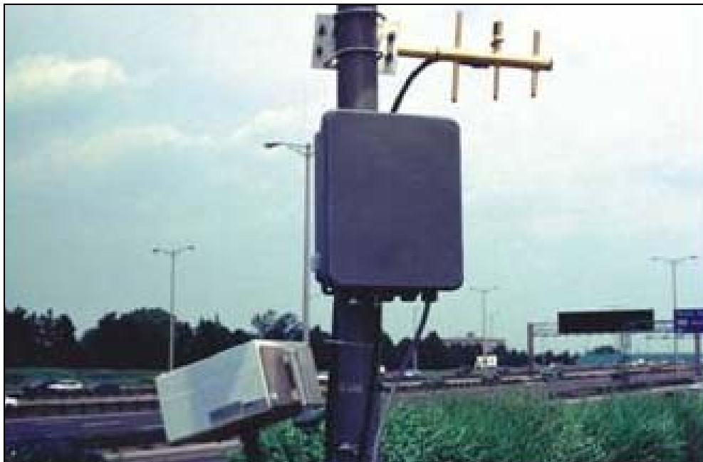
Figura 5.9 Sensor remoto de tráfico por microondas RTMS
