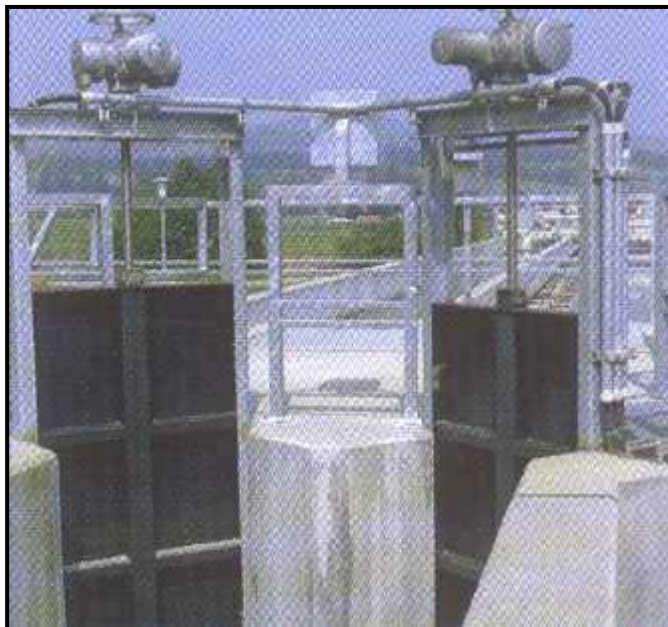
Figura 2. Compuertas tipo guillotina de desplazamiento vertical
