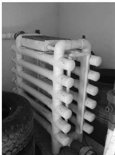
Figura 1.13 Sistema de desinfección
