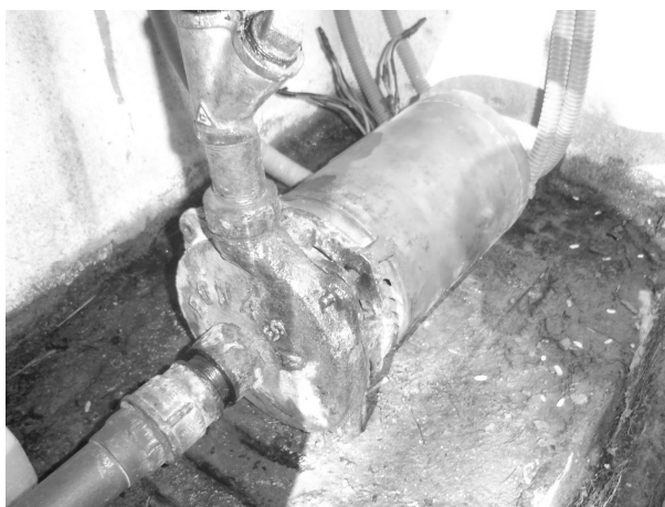
Fig. 1.2. Bomba de 2 HP para bombeo de agua al tanque de almacenamiento
