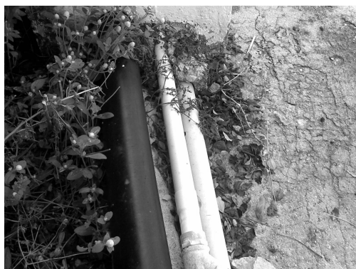
Figura 1.11. Tuberías de conducción
