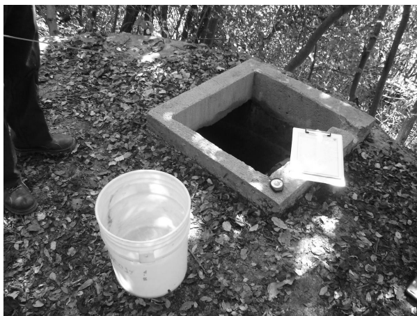
Fig. 1.1. Tanque elevado de almacenamiento
