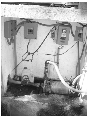
Fig. 1.4. Controles eléctricos del equipo de bombeo
