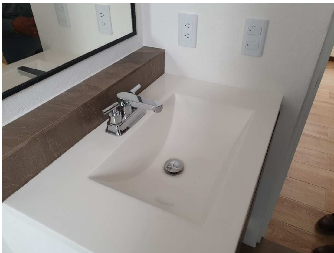
Contacto en baño, sin interruptor de circuito por falla a tierra; con base en la sección 210-8 a).
