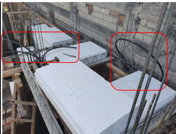
Congruencia entre lo indicado en planos y lo ejecutado en campo.
