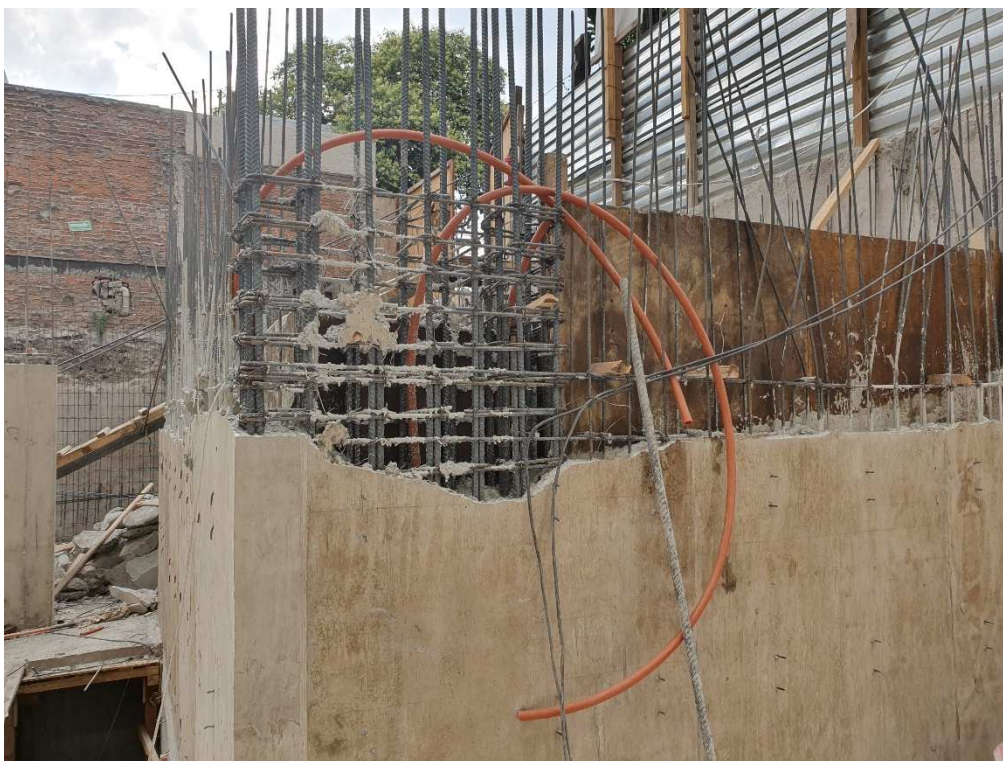
Uso de tubería Conduit de polietileno en construcciones de más de tres niveles sobre nivel de calle; con base en la sección 364-3.
