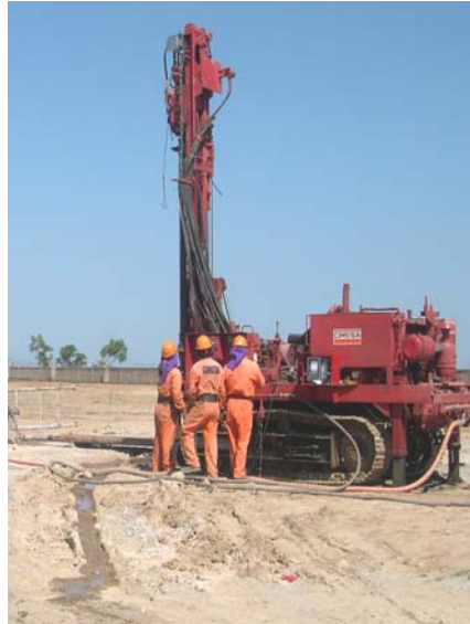
Fig. 1.14 Equipo de inyección
