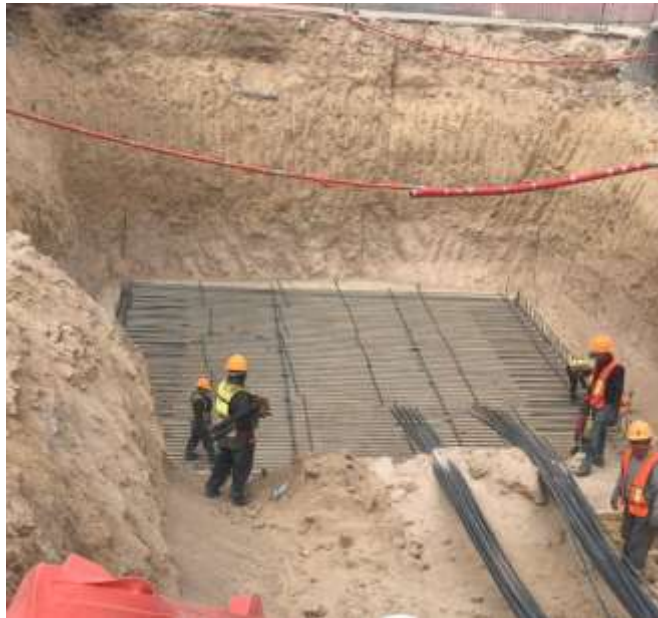
Imagen 10. Trabajos de colocación de acero de refuerzo para armado de parrilla inferior para losa de pasarela subterránea sur-poniente. Imagen propia.
