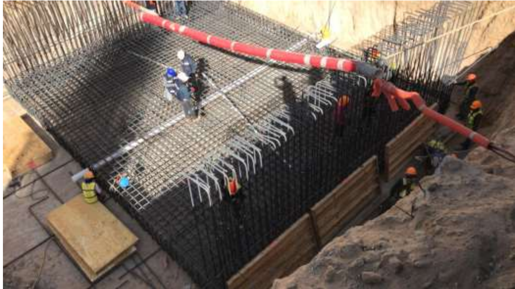
Imagen 14. Trabajos de verificación de colocación de acero de refuerzo para armado de losa inferior y muros de pasarela subterránea sur-poniente. Imagen propia.
