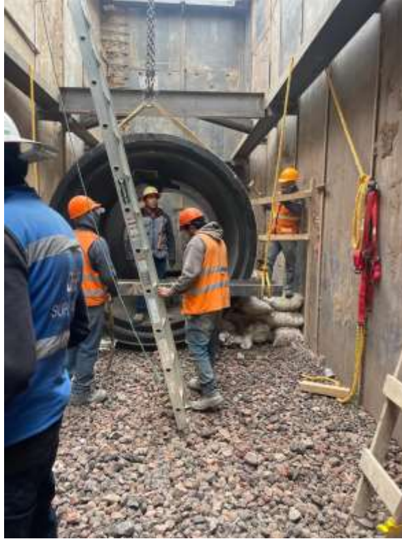
Imagen 27. Trabajos de izaje y acople de tubería de concreto del Colector Río Tacubaya. Imagen propia.
