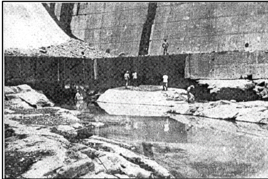
Figura 3.2 Vista de los daño en el tanque amortiguador (SÁNCHEZ BRIBIESCA & CAPELLA VISCAÍNO, 1973)
