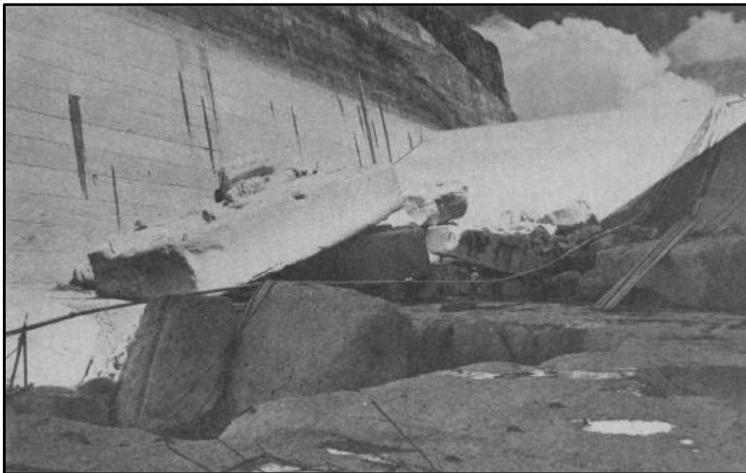
Figura 1.13 Vista en la elevación 70 del tanque de amortiguamiento dañado (BRIBIESCA, 1979)
