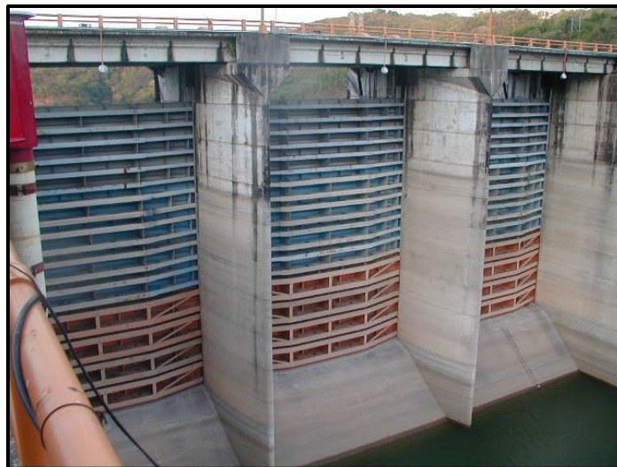
Figura 1.17 Obturadores cerrando el vertedor de servicio (CFE, SUBDIRECCION DE GENERACIÓN, 2011)
