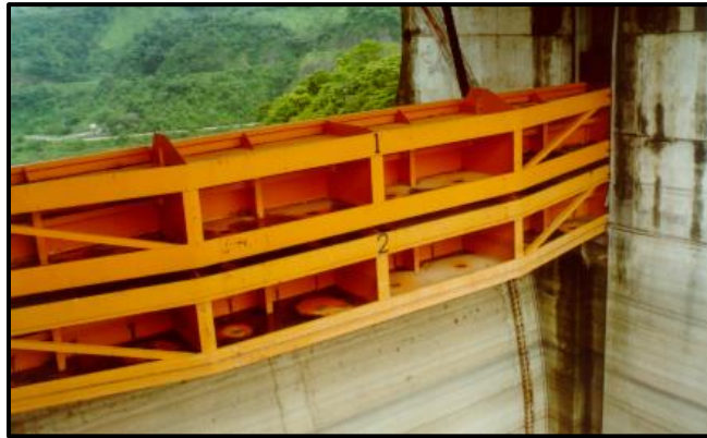
Figura 1.16 Obturadores utilizados de pantalla en la emergencia de 1999 (CFE, SUBDIRECCION DE GENERACIÓN, 2011)
