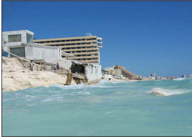
Figura VI.41. Vista de la playa de Cancún después del paso del huracán Wilma
