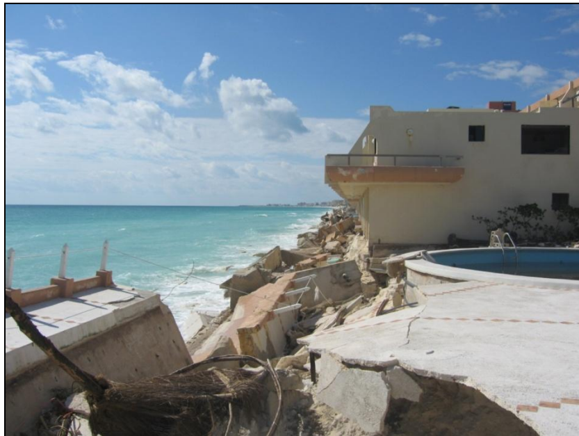
Figura VII.7. Daños a las instalaciones turísticas provocados por el ataque directo del oleaje generado por el huracán Wilma
