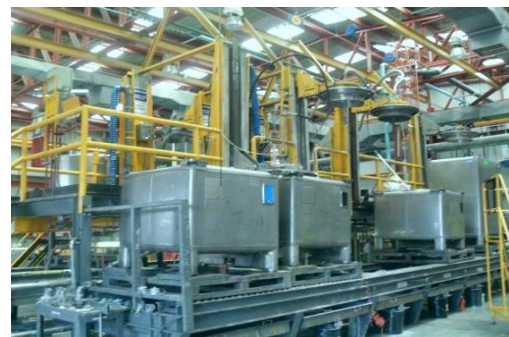
Figura 3.10.2 Línea de lavado 1
