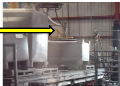
Figura 3.52 Operación automática después de instalar el scrubber
