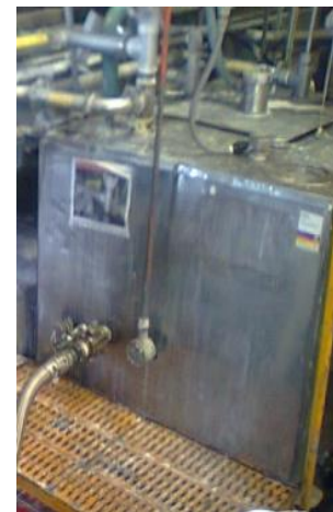
Figura 3.12 Tanque de almacenamiento de hidróxido de sodio
