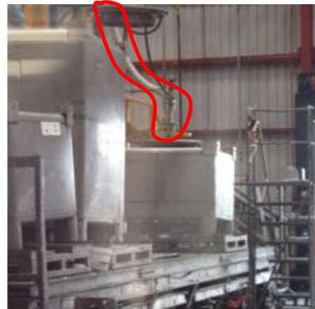
Figura 3.46 Operación automática de extracción de vapores, durante el ciclo de lavado a base de sosa
