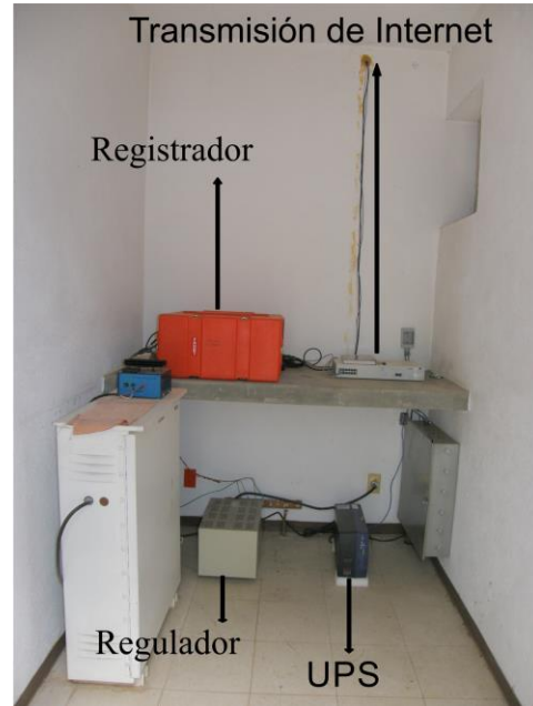
Figura 3.3 Interior de la estación MOIG. Izquierda: el cuarto con los instrumentos. Derecha: el cuarto con equipo eléctrico y de comunicación (Servicio Sismológico Nacional, 2017).
