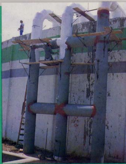
Conexión del Acueducto al tanque "Cerro G
