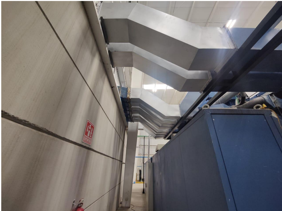
Imagen 10. Extensión de ductos quemador – horno. [14]
