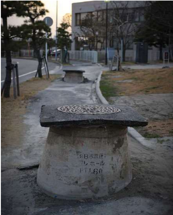
Figura 5. Las tapas del sistema de alcantarillado subterráneo se salieron de la banqueta debido a la subsidencia provocada por la licuefacción. Tomada de Keller y DeVecchio (2019).
