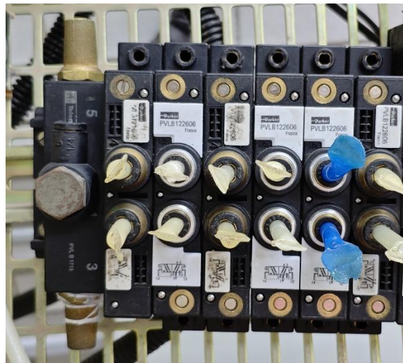
Ilustración 33: válvula 5/2 monoestable a la izquierda y válvulas 5/2 biestables
