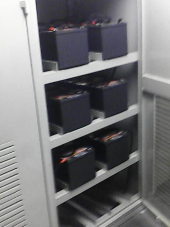
Imagen 12. Banco de Baterías.
