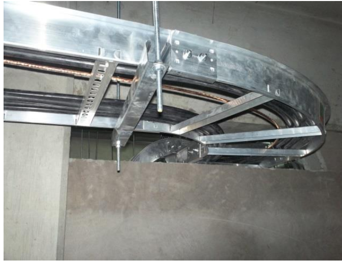
Imagen 7. Canalización, tramo de Charola tipo escalera
