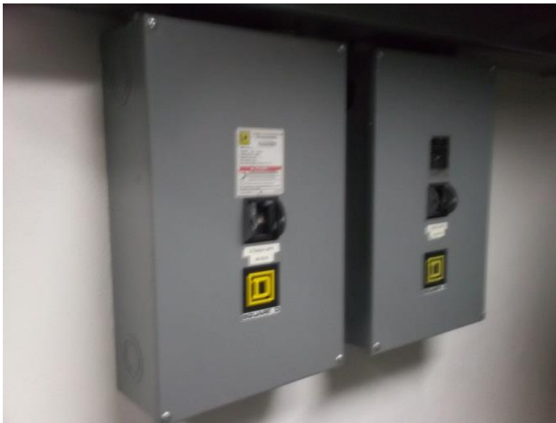
Imagen 6. Tablero de caja moldeada con Interruptor
