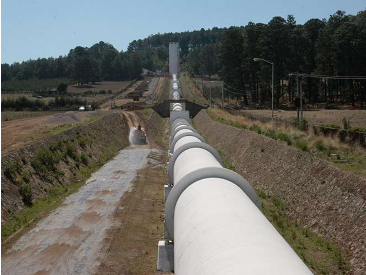
Fig. 3.1 Tercera línea del acueducto Cutzamala. 5
