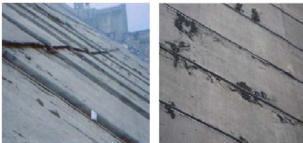
Figura 1.5.- Daños en la cara de concreto de la presa Zipingpu por el sismo de Wuenchuan en la región del Tibet en China en el año de 2008 (Zeping, 2009)
