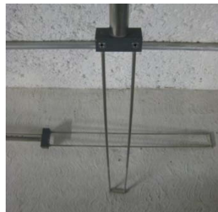
Figura 2.4 Sensores de nivel
