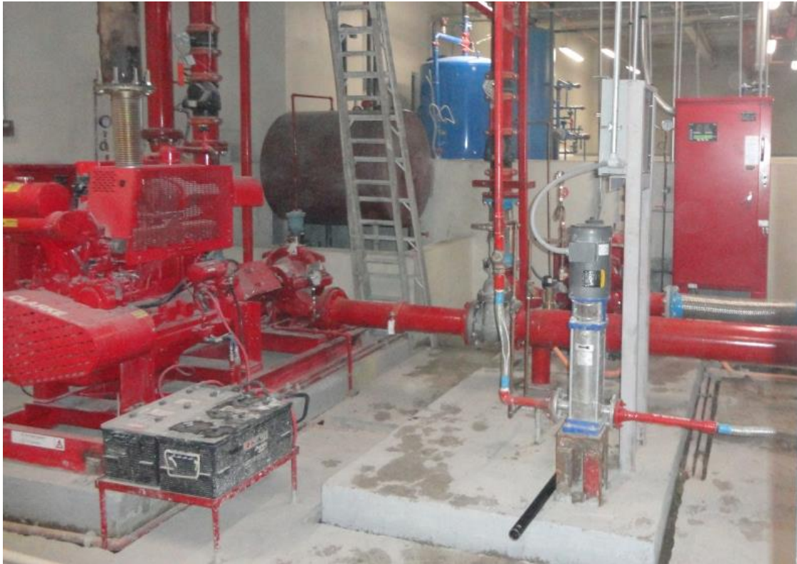
(Equipo de bombeo del sistema de protección contra incendio hotel Aeropuerto- Ciudad de México, tomada por el autor)
