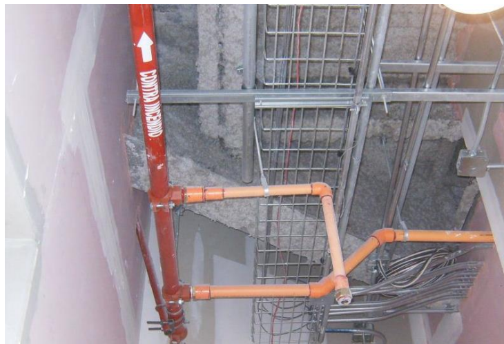
(Señalización en niveles tipo, sistema de protección contra incendio hotel Aeropuerto- Ciudad de México, tomada por el autor)
