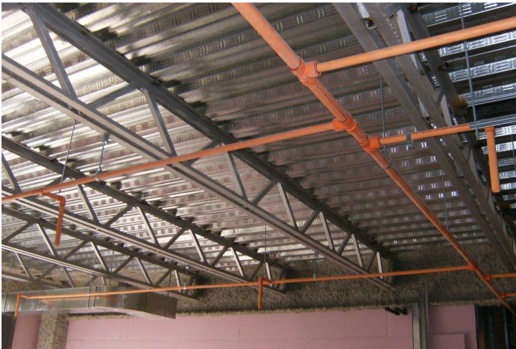
(Cabezal principal y líneas derivadas en niveles tipo del sistema de protección contra incendio hotel Aeropuerto- Ciudad de México, tomada por el autor)
