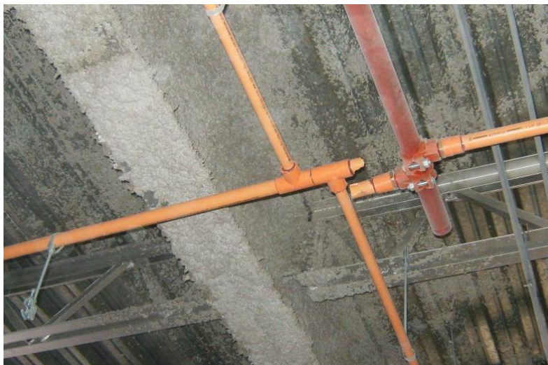
(Fractura de tubería debido a golpe de ariete en soporte tipo colgante, sistema de protección contra incendio hotel Aeropuerto- Ciudad de México, tomada por el autor)
