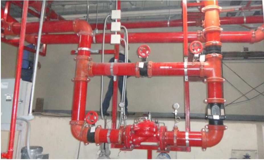
(Arreglo de By-pass para la válvula reguladora de presión del sistema de protección contra incendio hotel Aeropuerto- Ciudad de México, tomada por el autor)
