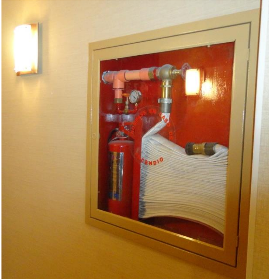
(Gabinete para manguera en niveles tipo, sistema de protección contra incendio hotel Aeropuerto- Ciudad de México, tomada por el autor)
