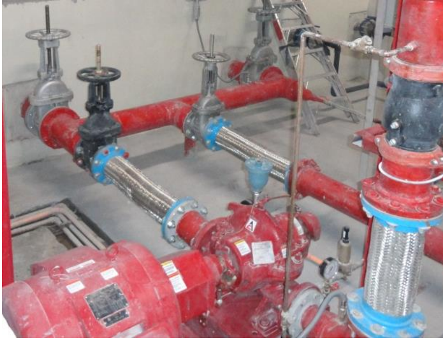
(Cabezal de succión conectado a cisterna del sistema de protección contra incendio, hotel Aeropuerto- Ciudad de México, tomada por el autor)
