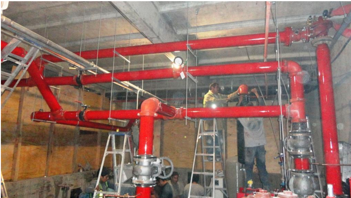
(Cabezal de descarga del sistema de protección contra incendio, hotel Aeropuerto- Ciudad de México, tomada por el autor)
