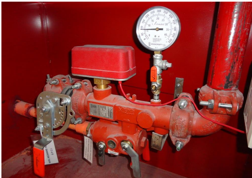
(Arreglo tipo Riser, sistema de protección contra incendio hotel Aeropuerto- Ciudad de México, tomada por el autor)
