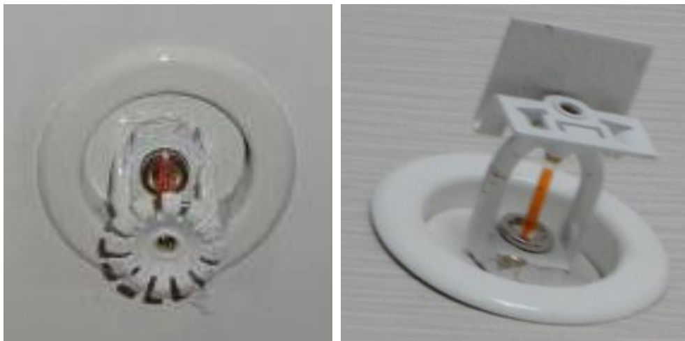
(Rociadores tipo pendent y de pared, de respuesta rápida de 135 F, colocados en habitación tipo, sistema de protección contra incendio hotel Aeropuerto- Ciudad de México, tomadas por el autor)
