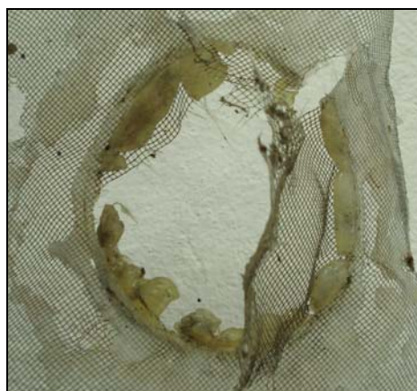
Figura 4.3. Fotografía de la malla dañada
