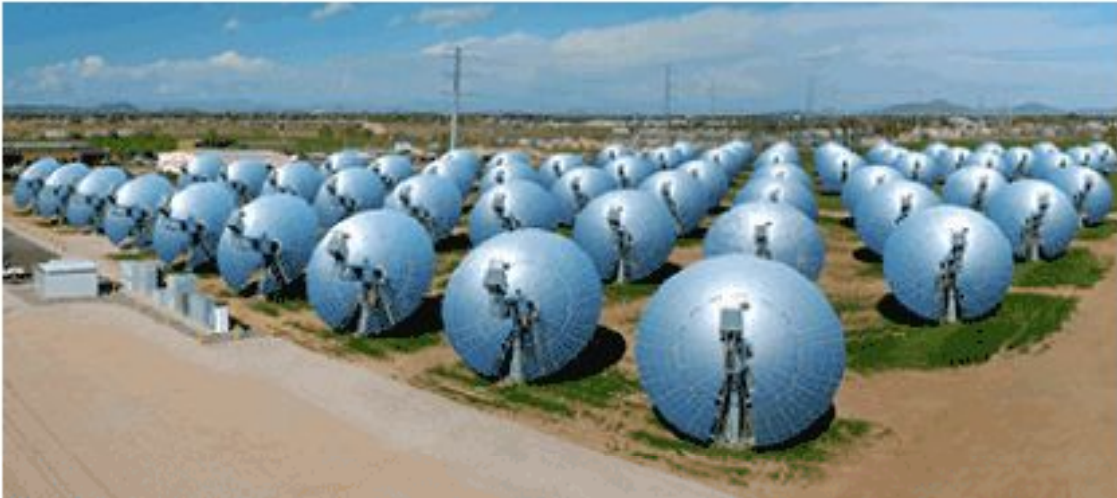
Figura 1.6. Planta de generación solar mediante sistemas Disco-Stirling “Maricopa Solar Power Plant” en el desierto de Arizona. Fuente: [2].
