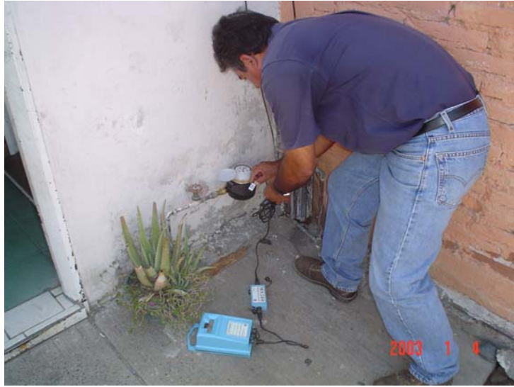
Ilustración 7-4 Instalación, programación y almacenamiento de datos en campo
