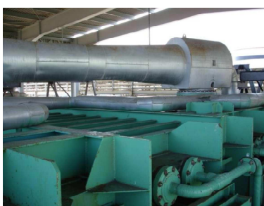
FIGURA 3. 21 Sistema de calentamiento de la desaladora MED [IMPULSA, 2008]
