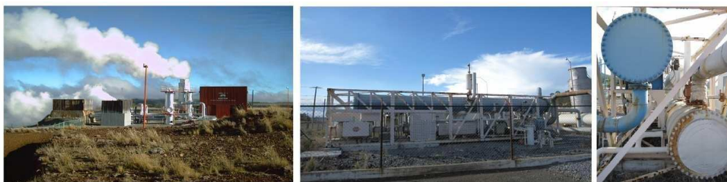
FIGURA 3.12 Intercambiadores de calor de la planta geotérmica Los Hornos, Puebla.
