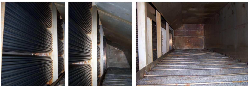
FIGURA 3. 30 Vista interna de una cámara de desalación de una planta MED [IMPULSA, 2008]
