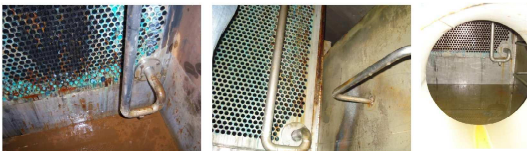
FIGURA 3. 28 Evaporador de la cámara desaladora MED [IMPULSA, 2008]
