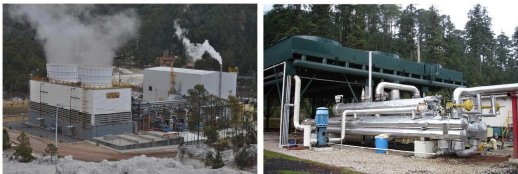
FIGURA 3.10 Intercambiadores de calor de la planta geotérmica Los Azufres. A la izquierda se observan torres de enfriamiento húmedas de la planta de condensación y a la derecha se muestran las torres de enfriamiento secas junto con los Intercambiadores de calor tubulares. (IMPULSA IV, Instituto de Ingeniería UNAM, 2008)
