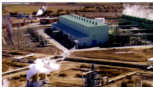
FIGURA 2. 14 Central geotermoeléctrica Cerro Prieto [Comisión Federal de Electricidad, 2006]
