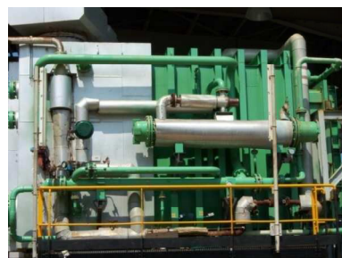
FIGURA 3. 20 Sistema de vacío de la desaladora MED [IMPULSA, 2008]
