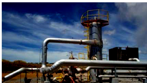
FIGURA 2. 16 Central geotermoeléctrica Los Humeros [Proyecto IMPULSA IV, Instituto de Ingeniería, UNAM 2009]
