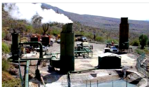
FIGURA 2. 17 Central geotermoeléctrica Las Tres Vírgenes [Proyecto IMPULSA IV, Instituto de Ingeniería, UNAM 2009]
