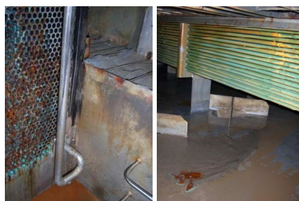
FIGURA 3. 22 Sistema de evaporación de la desaladora MED
