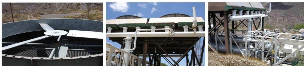
FIGURA 3.11 Intercambiadores de calor de la planta geotérmica Tres Vírgenes. De izquierda a derecha: A) Ventilador de la torre de enfriamiento seca, B) Torre de enfriamiento seca y C) Intercambiadores de calor tubulares. (IMPULSA IV, Instituto de Ingeniería UNAM, 2008)
