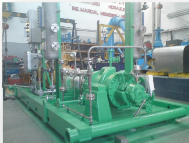
Fig. 15 Bomba centrífuga utilizada en instalaciones del campo Chicontepec.
