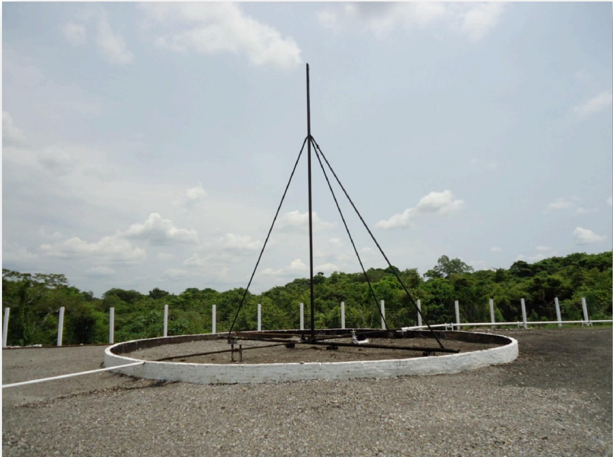
Fig. 39 Quemador apagado, resultado de los esfuerzos encaminados hacia un óptimo aprovechamiento de gas.
