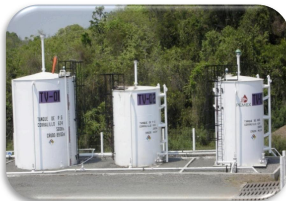
Fig. 14 Tanques de almacenamiento
