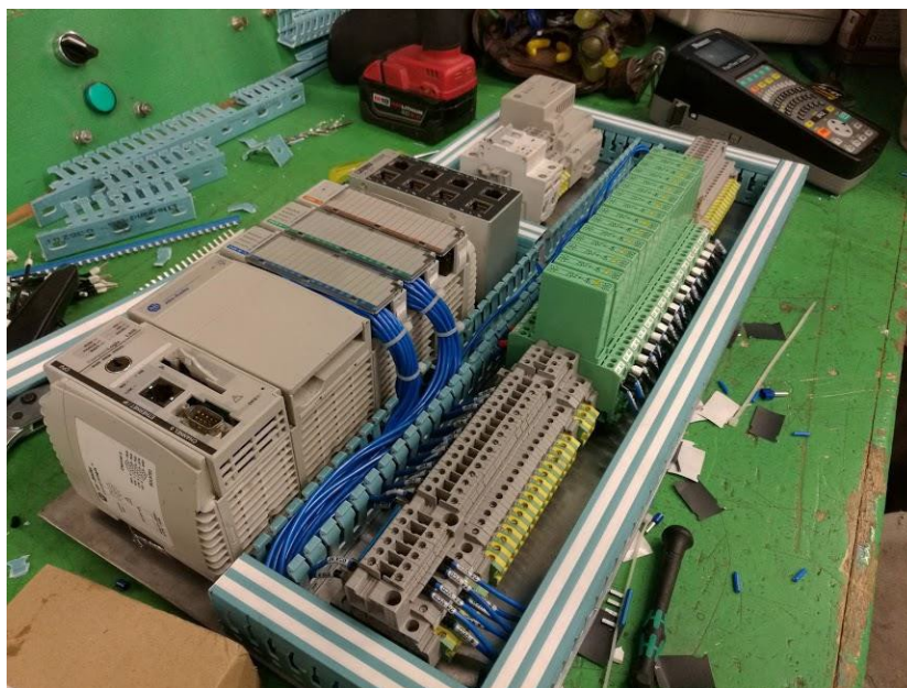
Fig. 6.18 Cableado de los dispositivos
