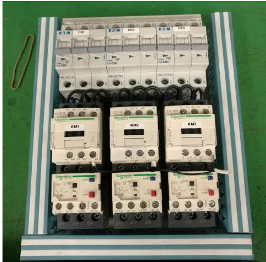
Fig. 6.19 Tablero de Fuerza
