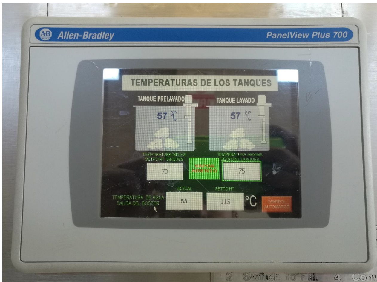
Fig. 6.47 Pantalla de temperaturas de tanques
