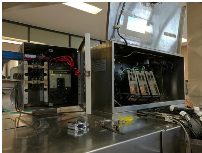
Fig. 6.33 Etiquetado de cables
