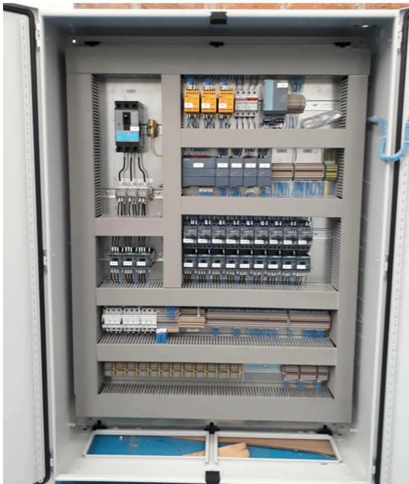
Figura 2.5: Imagen ilustrativa de un tablero de control y fuerza
