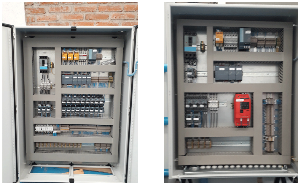
Figura 4.2: Tablero área de Documentación (izq.) Tablero área de Reclamo (der.)
