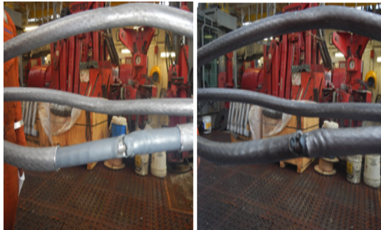
Figura 4.2: Daño en uno de los conductores del cable de potencia por aplastamiento.
