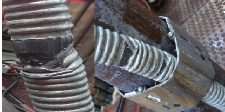
Figura 3.4: Cable de potencia dañado.
