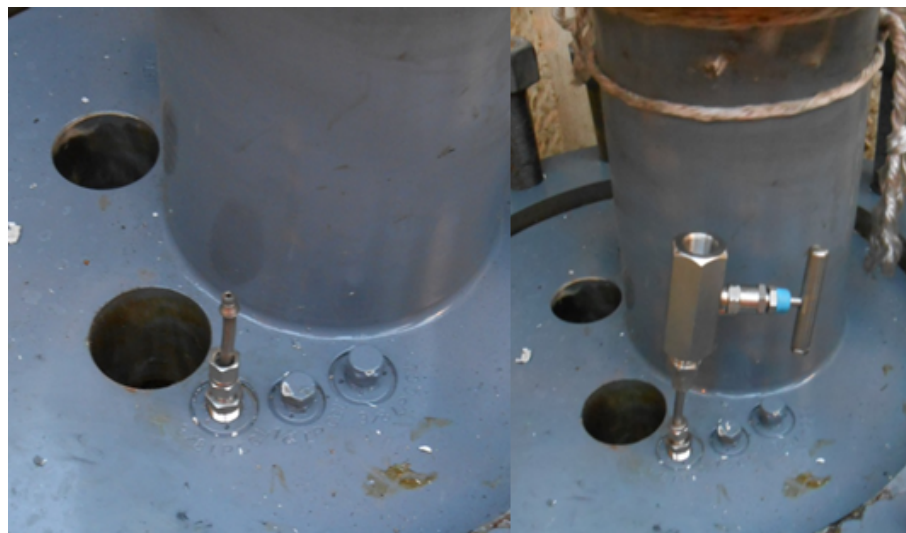
Figura 4.10: Tornillo de terminación instalado de manera “pasante”.
